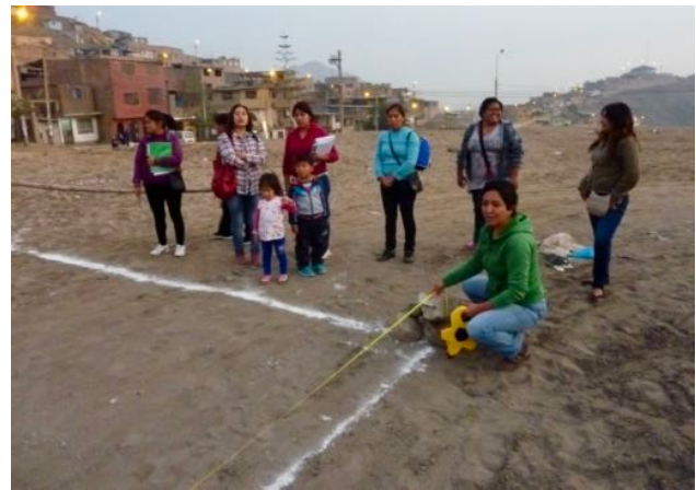
Die Pläne sind bereinigt, die Architektin zeigt wo gegraben werden muss und gibt das Zeichen zum Start.
