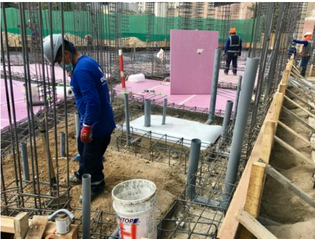
Das Gebäude muss erdbebensicher gebaut werden, die Betonkonstruktion wird mit viel Armierung bewehrt.
